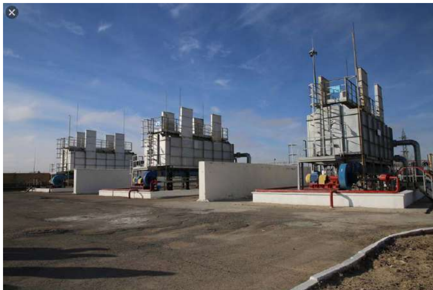
Рисунок 1.1 – Головная насосная станция «Жетібай»
