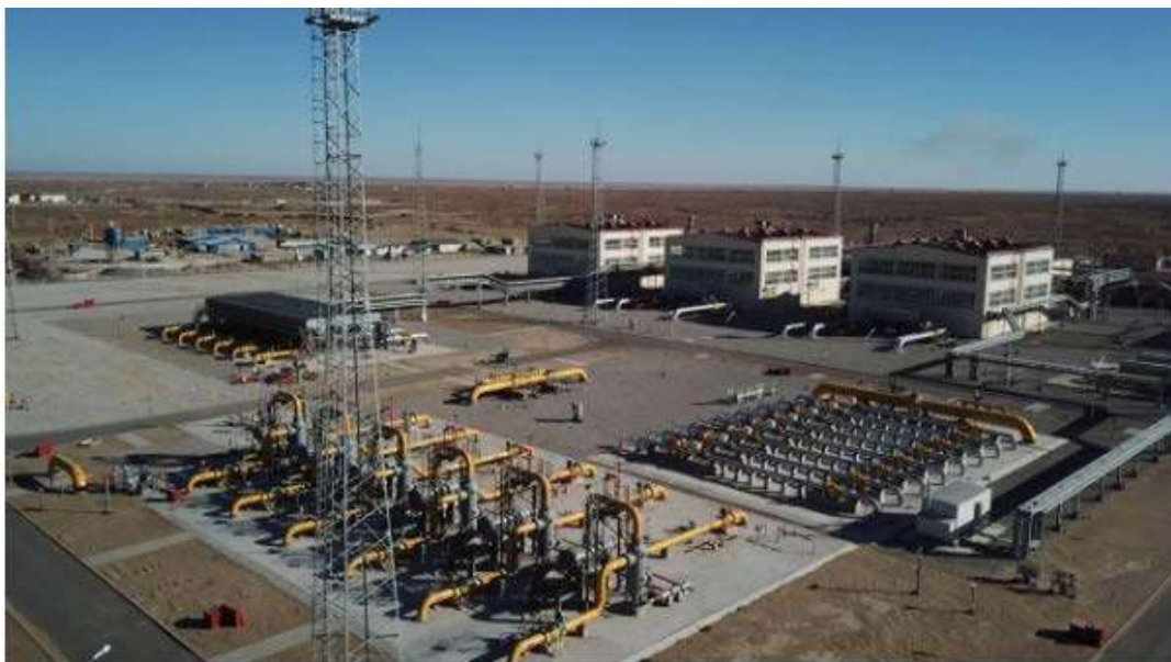
Рисунок 1.8 – Компрессорная станция СКС-1 газопровода Казахстан-Китай
