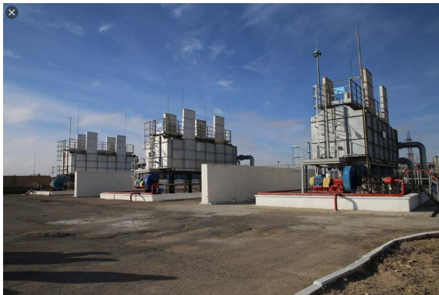
Рисунок 1.1 – Головная насосная станция «Жетібай»
