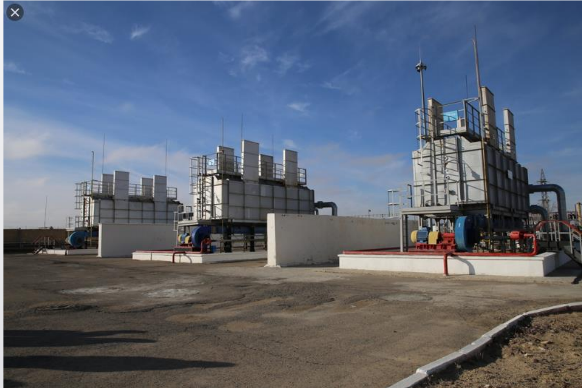
Рисунок 1.1 – Головная насосная станция «Жетібай»
